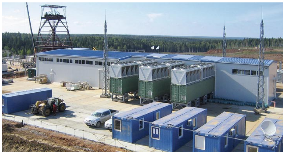
Bild 1: Pumpenhalle mit Bodengefrieranlage
