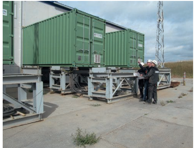
Blick auf die Heizmaschinen während der Inbetriebnahme
