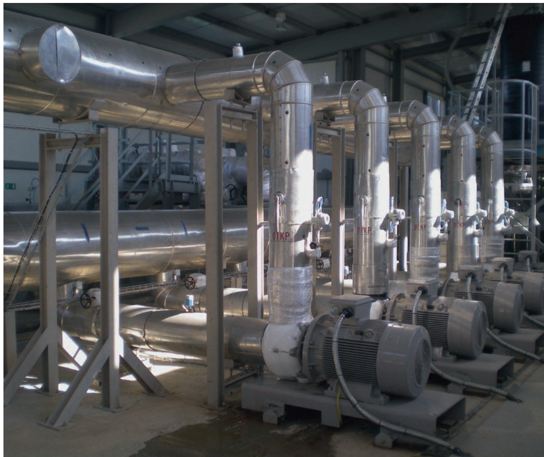
Kreiselpumpen zur Zirkulation des Kälte- bzw. Wärmeträgers
