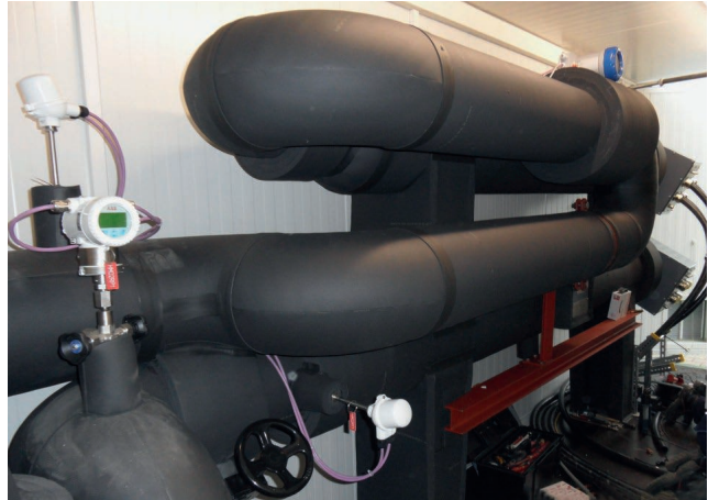
Innenansicht der Heiz- maschinen mit Blick auf die Erhitzer
