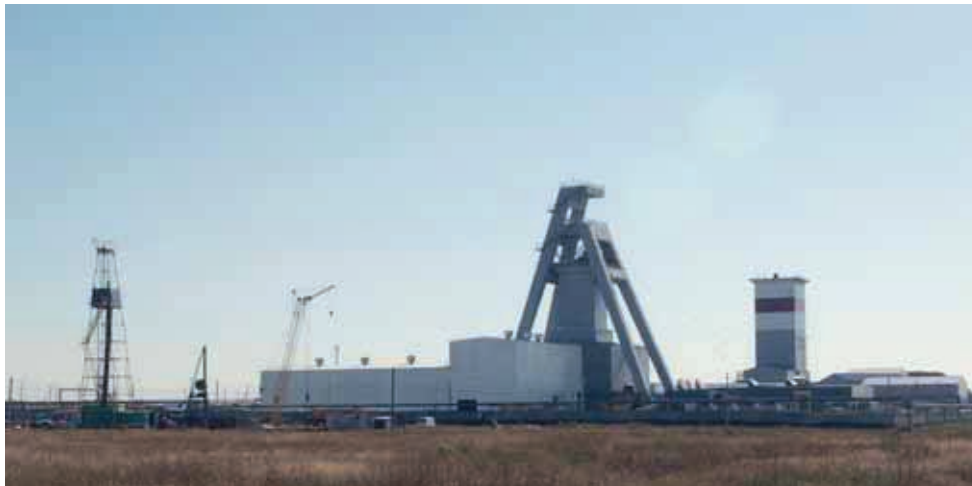
Abbildung 1: Blick auf die drei Schachtbau- plätze des Bergwerkes EuroChem- WolgaKali; von links: zweiter Skipschacht, erster Skipschacht, Serviceschacht
